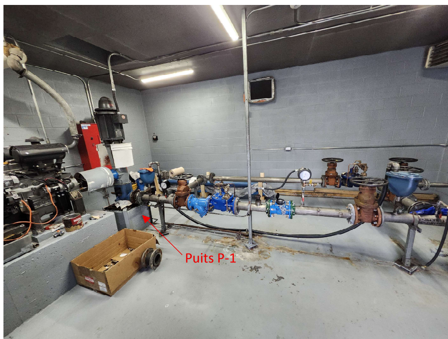
3. Vue du système de pompage du puits P-1
