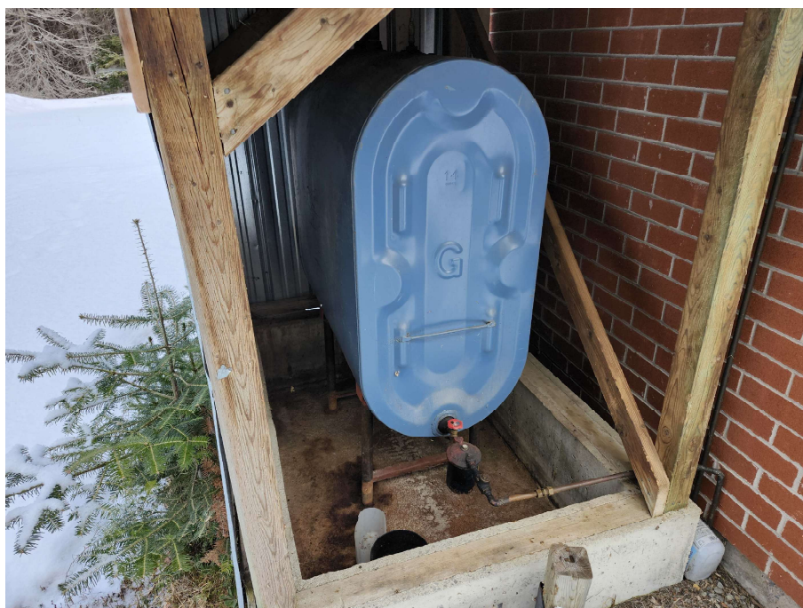
2. Vue du réservoir extérieur de la génératrice d'urgence
